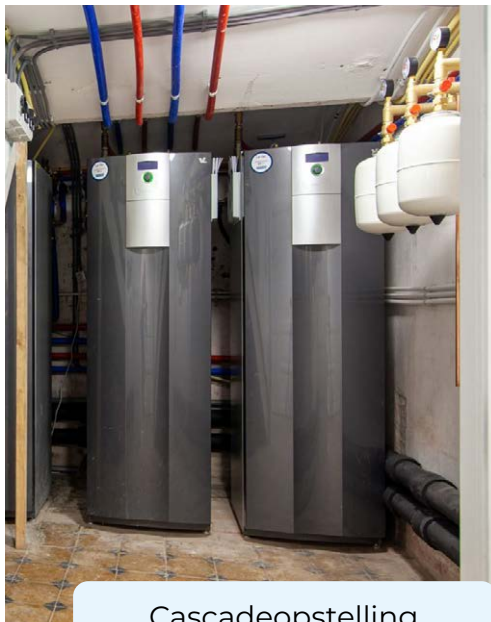
Cascadeopstelling binnendeel in kelder
