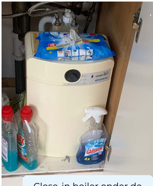
Close-in boiler onder de gootsteen
