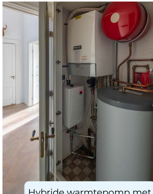
Hybride warmtepomp met boilervat, kastopstelling
