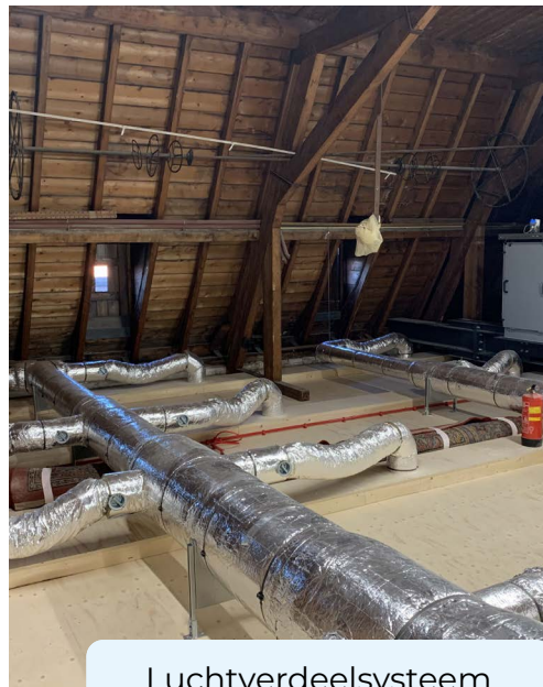
Luchtverdeelstelsel op zolder
