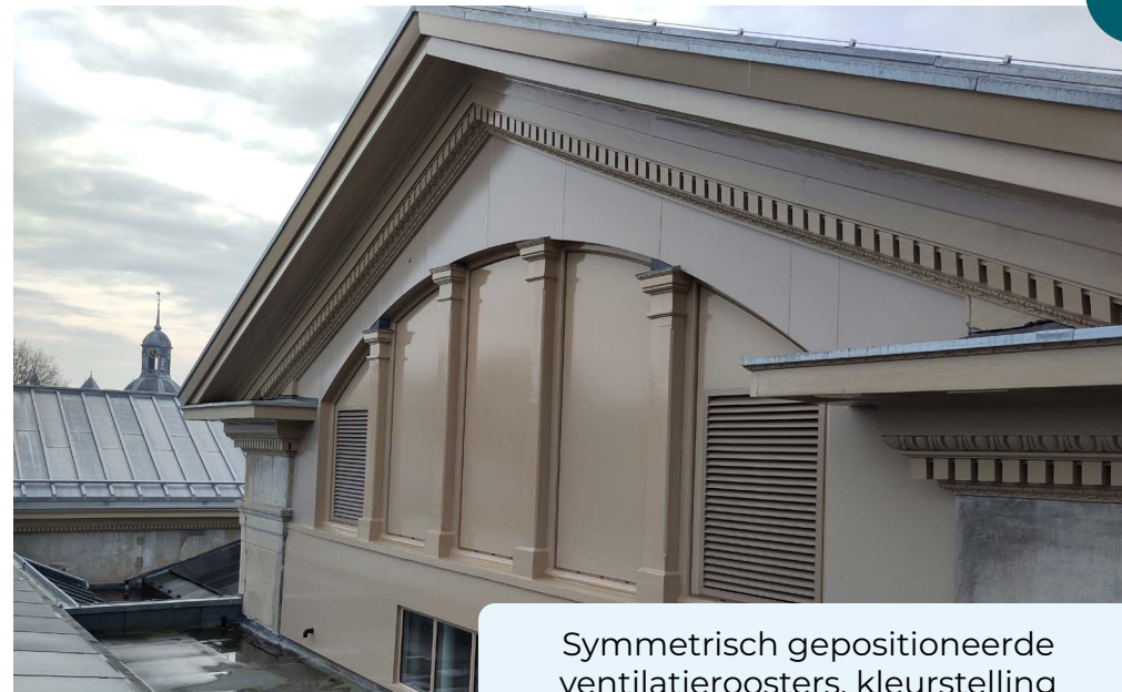
Ventilatie-rooster ter plaatsen van de zakgoot, uit het zicht
