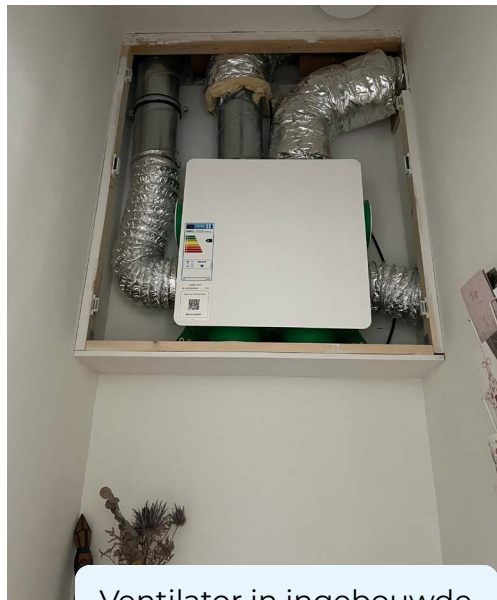
Ventilator in ingebouwde wandkast
