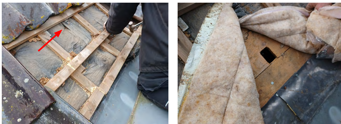
Figuur 9 De tape waarmee de foliebanen aan elkaar zijn geplakt laat plaatselijk los, waardoor geen sprake is van een dampdicht systeem.
