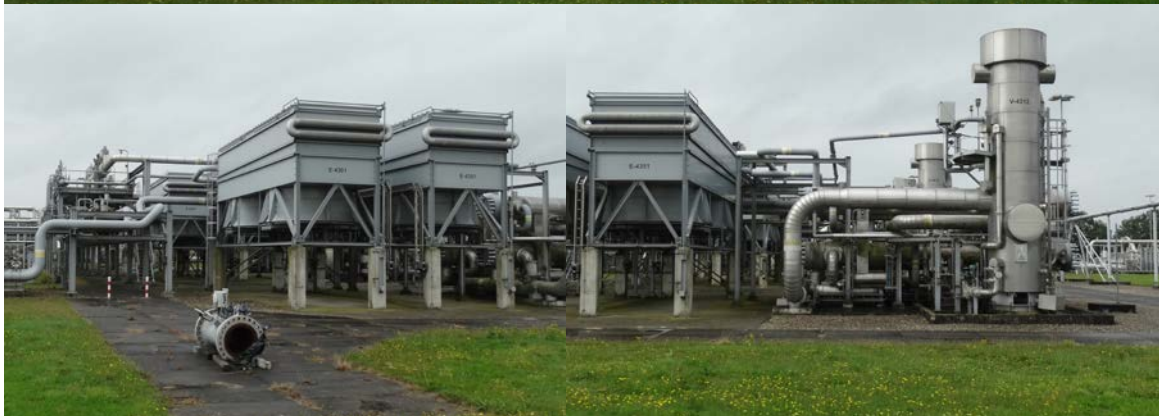
19 Behandelingstrein Tusschenklappen, 27 augustus 2024. Van rechts naar links, in de richting van het gas, separatoren, in-stallaties waar het gas wordt gescheiden van condensaat en productiewater en de pijp waar het gas de grond inging naar het overslagstation, in dit geval aan de andere kant van de weg. Links de tanks waar het condensaat werd opgeslagen, erachter de controlekamer.
