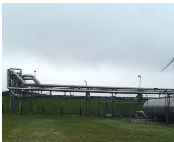
51 Tankenpark Delfzijl, de buizen die het aardgascondensaat van de tanks op schepen overladen, 5 januari 2024
