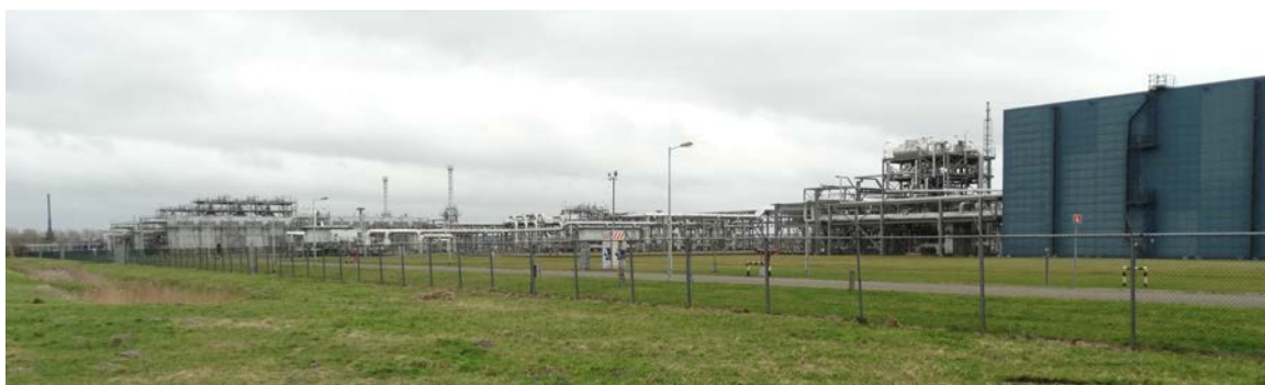
46 De NAM-locatie bij Grijpskerk (o.a. gasopslag) is vanwege de schaal onmogelijk in één foto te vangen, 6 februari 2024
