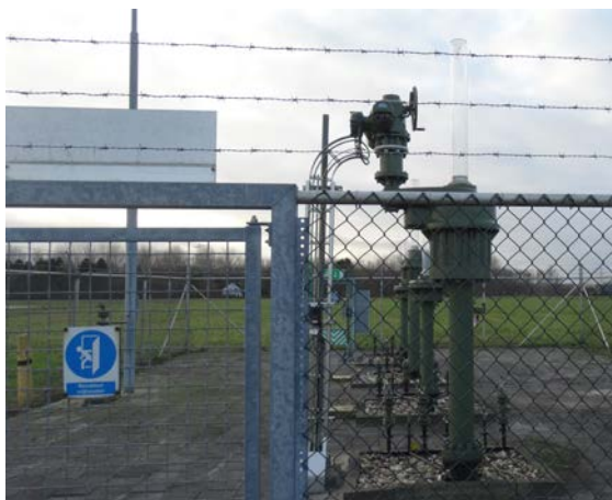
49 Afsluiter overslag Tjuchem Noord, 4 januari 2024
