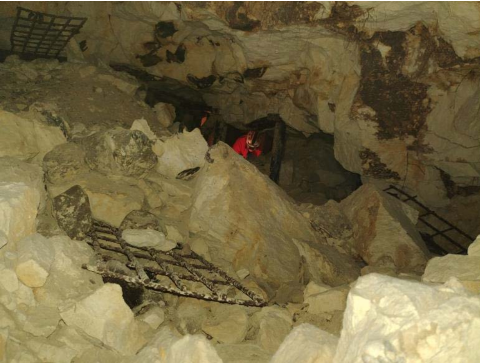
Figuur 8: Dragende stalen delen in en onder het puin van een instorting in de nabijheid van schacht 25, achter kijkvenster 17. Foto: Geocontrol.
