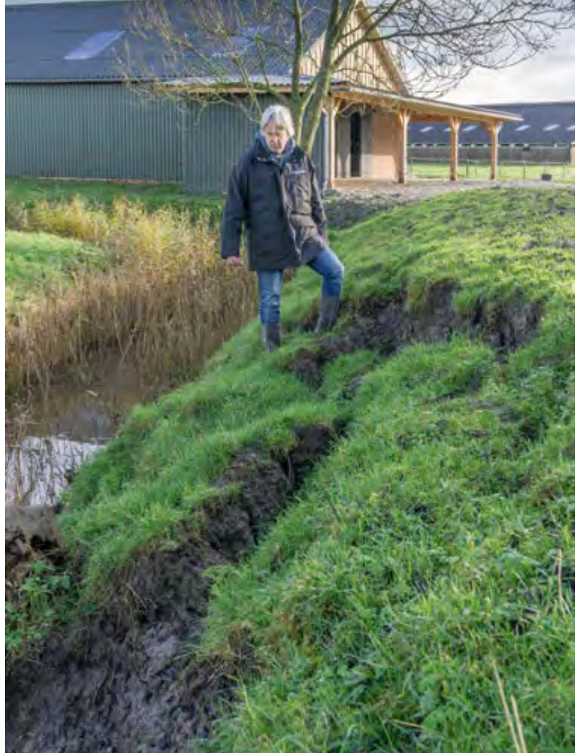
Afb. 4.4 De steilkant aan de noordzijde van de terp van Oostrum zakt in (rijksmonument 45.391). De oorzaak is niet duidelijk. Mogelijk wordt het veroorzaakt door het rottend wortelgestel van enkele omgekapt bomen. Het is echter ook mogelijk dat het stromende water in de omringende sloot voor hellinginstabiliteit zorgt, waardoor inzakkings ontstaat (foto: Van Doesburg & Stöver 2018).
