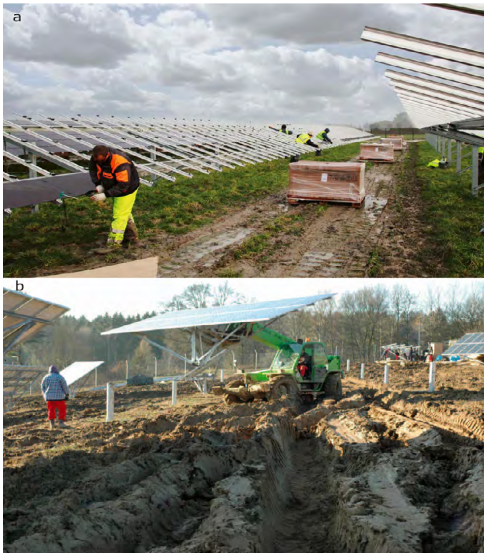
Afb. 5.8 a Aanleg zonnepark met geheide funderingsconstructie bij Hoofddorp (foto: SolarEnergyWorks 2017); b: Door insporing verstoorde bodem bij de aanleg van een zonnepark in Landkreis Straubing-Bogen (foto: Büttner & Husty 2015).
