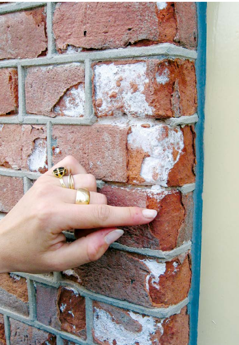
De waterafstotende toplaag kan door verborgen zoutuitbloei van bakstenen springen: 'laagvormig afspringen' door 'cryptoflorescentie' dus
