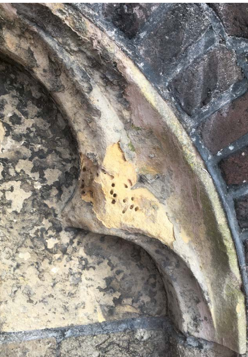
Insectengangen in mergel zijn een indicatie dat de samenhang van de steen niet meer voldoende is
