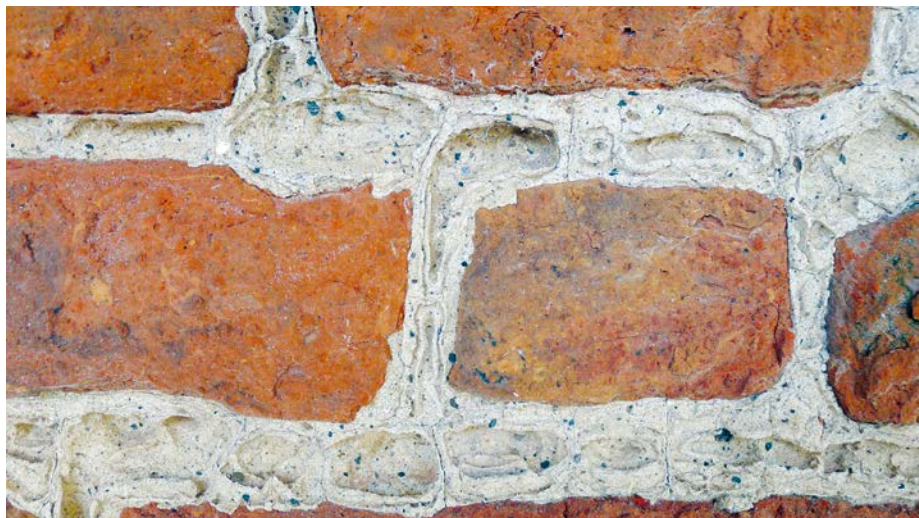
Vocht en zout laten voegmortel soms honingraatachtig desintegreren: 'alveolaire aantasting'
