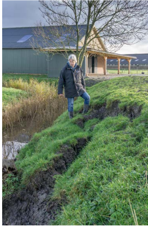
Afb. 4.4 De steilkant aan de noordzijde van de terp van Oostrum zakt in. De oorzaak is niet duidelijk. Mogelijk wordt de schade veroorzaakt door het rottend wortelgestel van enkele omgekapte bomen. Het is echter ook mogelijk dat het stromende water in de omringende sloot voor erosie zorgt, waardoor inzakking ontstaat.
