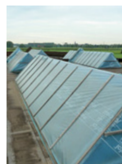
Deze daklichten zijn met folie tijdelijk waterdicht gemaakt
