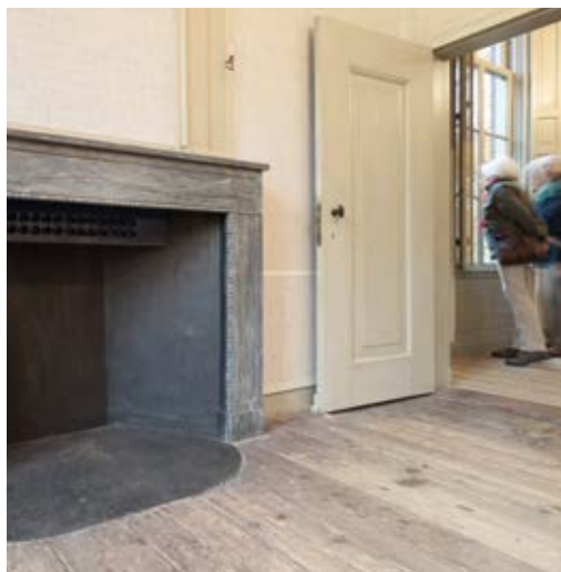
Voor een nieuwe klimaatinstallatie is handig gebruikgemaakt van de schoorsteenkanalen
