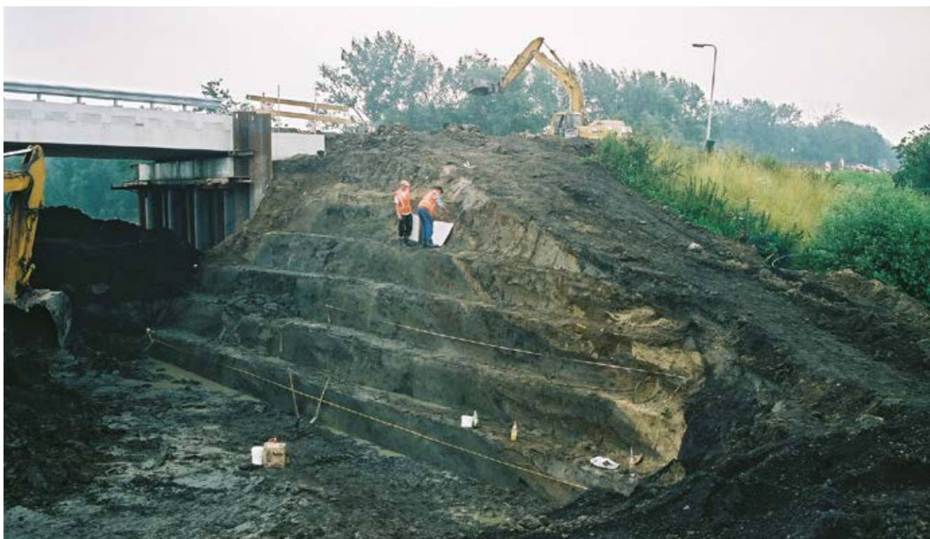
Voorbeeld van watergerelateerd onderzoek op het land: dijkonderzoek in het kader van de verbreding van de Rijksweg A2, doorsnede door de Diefdijk te Vianen (foto: BAAC).
