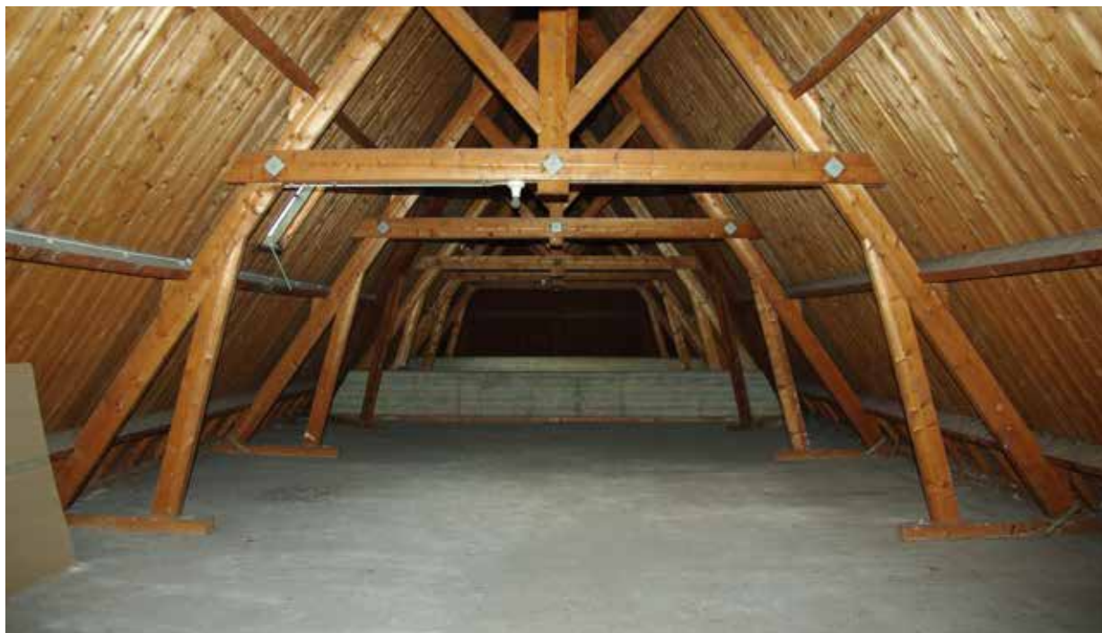
Afb. 74 Deel van een verbeterd Hollands spant in de kap van het postkantoor van Winterswijk uit 1938, voorzien van dubbel uit- gevoerde trekplaten die de makelaar inklemmen.
