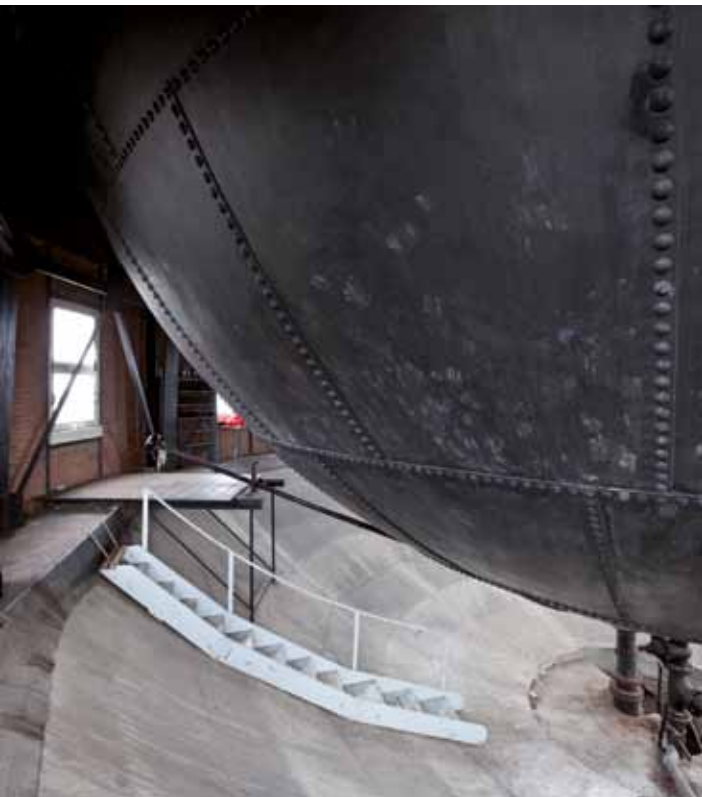
Onder het waterreservoir is een betonnen lekvloer aangebracht voor het opvangen van condens. Inspectie en onderhoud van het stalen reservoir werden vanaf de lekvloer uitgevoerd. Groningen, Noorderbinnensingel 14.
