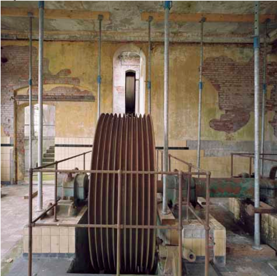
Kabelgeleider in de machinehal
