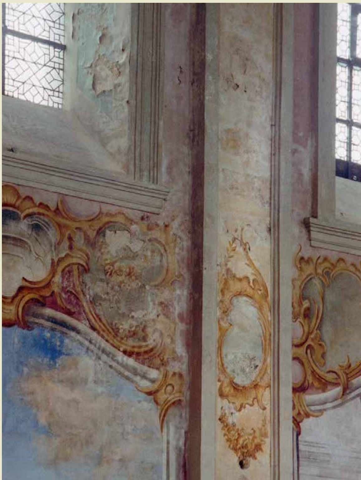
Houthem (Sint Gerlach), St. Gerlachuskerk. Schade door vocht aan de muurschilderingen die in 1872 zijn aangebracht over de schildering van J.A. Schöpf uit 1751 (foto RCE 1987)
