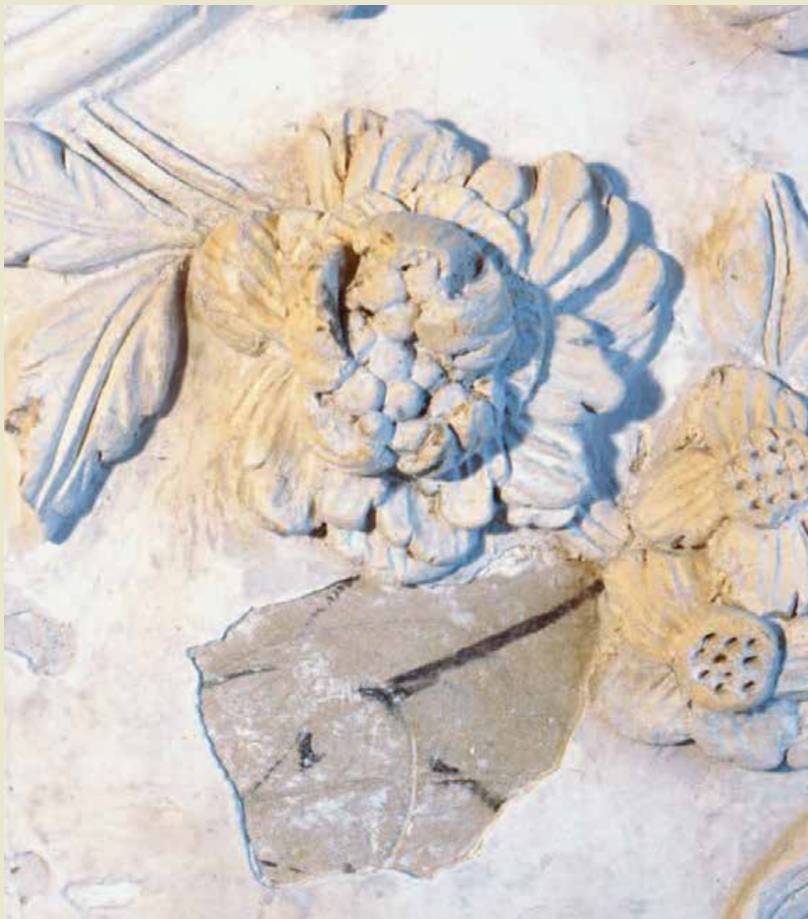
Gent, voormalig Caermersklooster, sacristie. Detail van het stucwerk uit 1753 waarop door een beschadiging de voortekening op de onderliggende raaplaag onder de stucwerkornamenten zichtbaar is (foto B. Delmotte)
