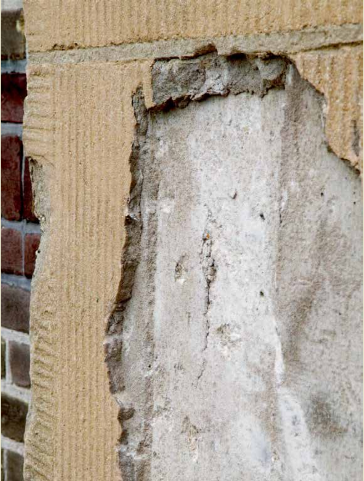
Rotterdam, Lloydstraat 30, Pakhuis Sint Jobsveem, gebouwd 1912-1914. Detail van het beschadigde cementgebonden buitenpleisterwerk met een imitatie vrijnslag (foto RCE 2005)
