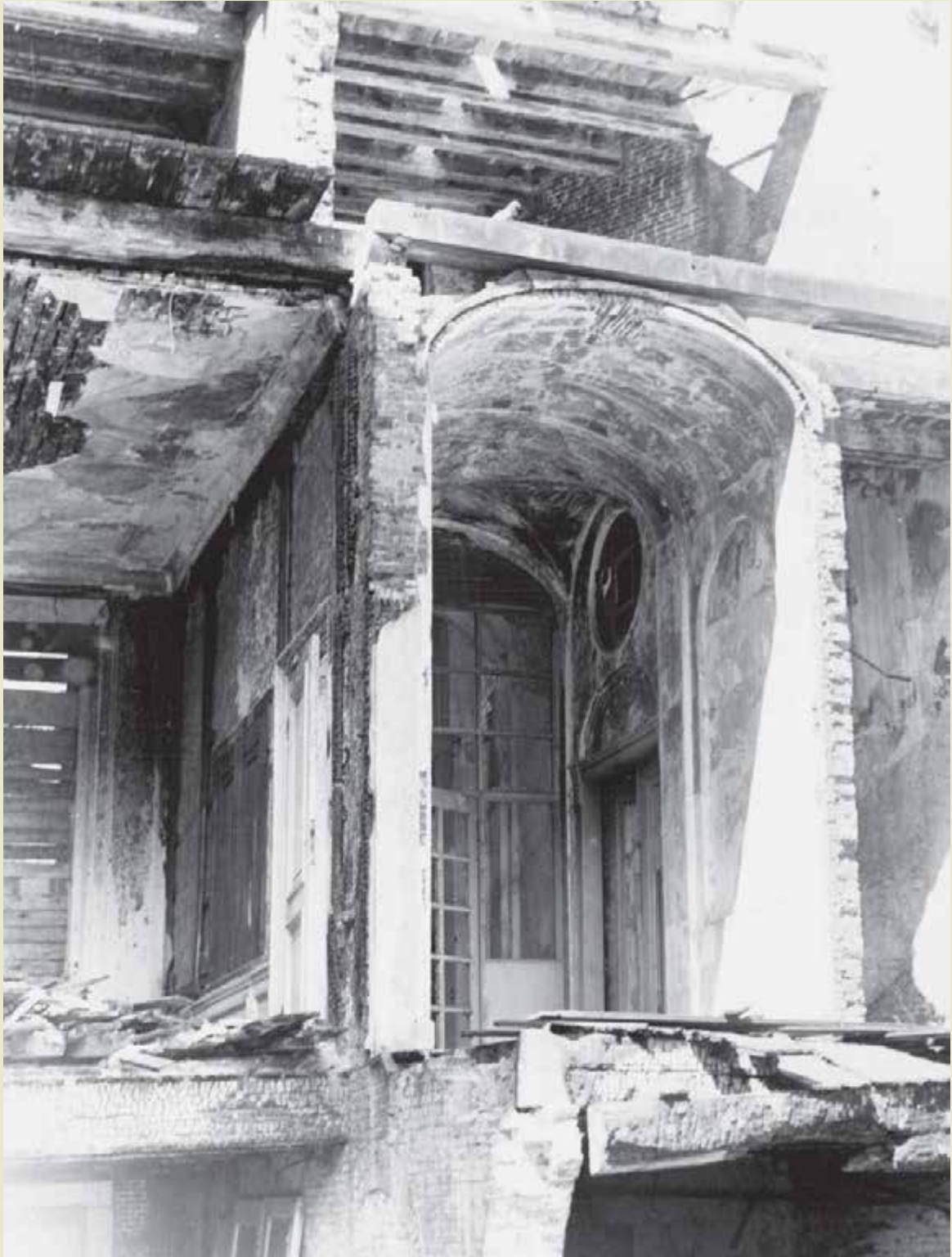
Amsterdam, Singel 295. Doornede ontstaan door brand en sloop van de achtergevel. De fotograaf staat op souterrain niveau en kijkt omhoog in de richting van de bel-etage. De vroeg achttiende-eeuwse gewelfde stucgang is ingebracht in het oudere casco. In doornede is het gewelf korbboogvormig (foto BMA, 1963).
