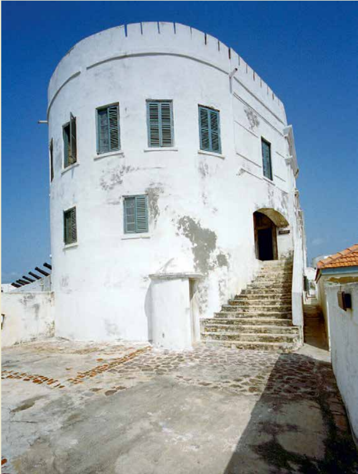
Cape Coast (Ghana), Fort Carolusburg. Het pleisterwerk aan de zeezijde van de Dalzel Tower van de gouverneurswoning heeft duidelijk te lijden van de weersinvloeden en het zeezout (foto RCE 2000)
