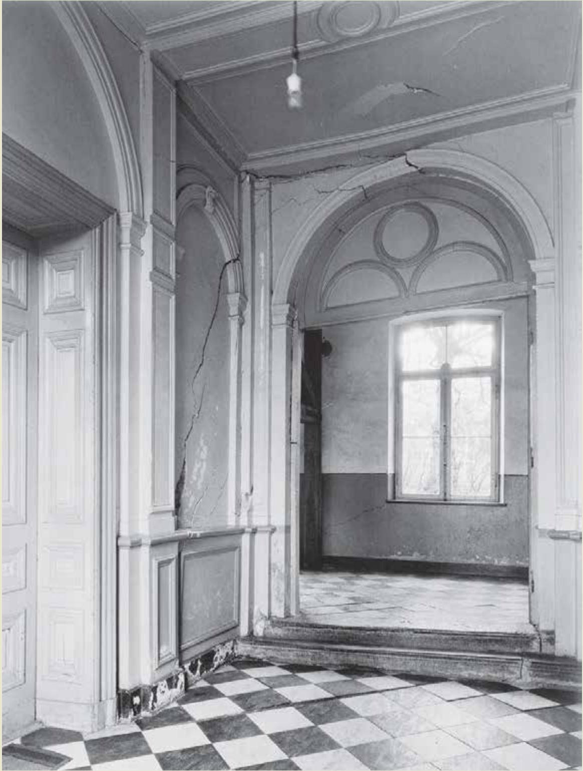
Rolduc, Abdij Kerk. Beschadigd pleisterwerk in hal van Klein Rolduc (foto RCE)
