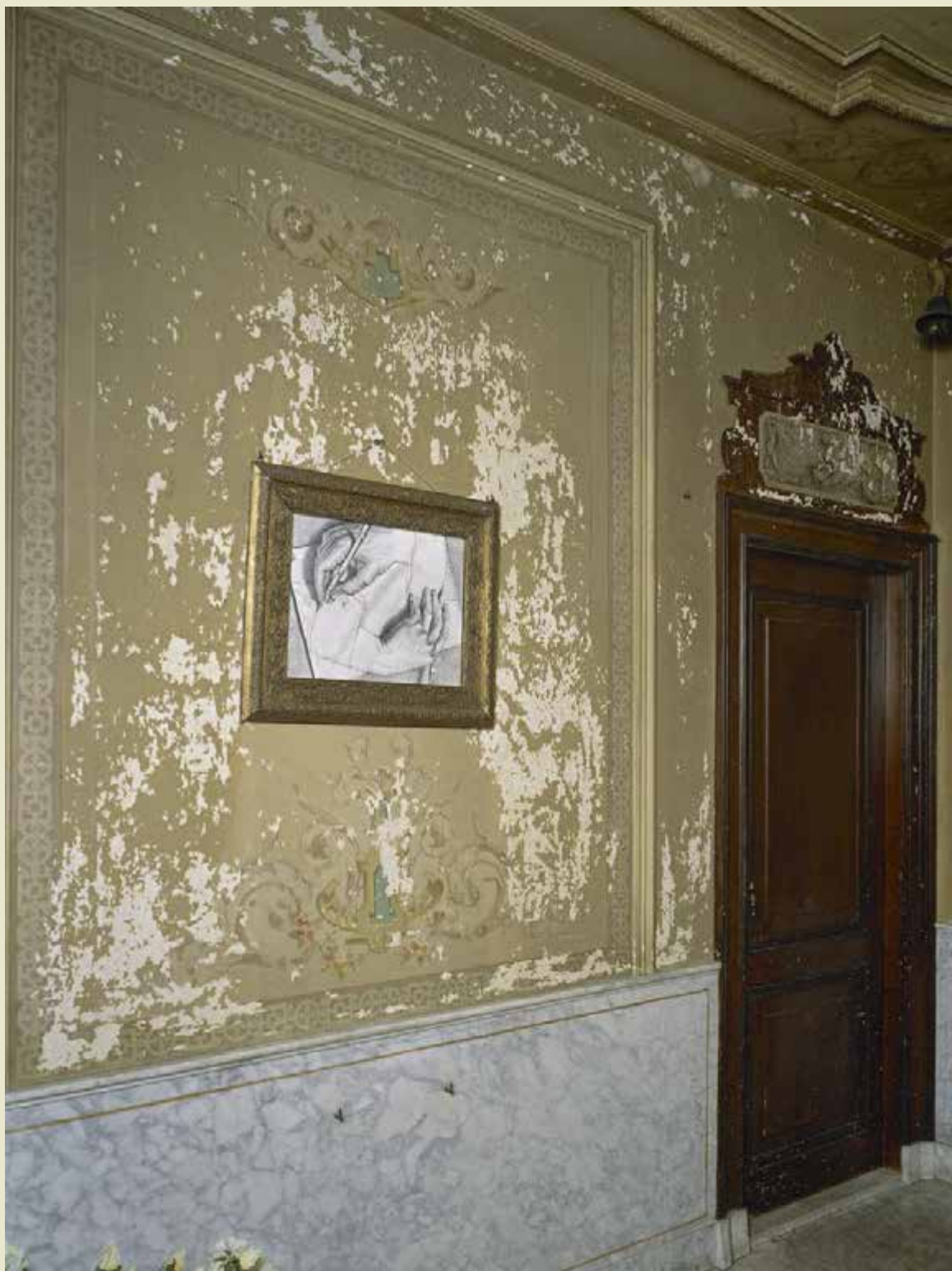
Baarn, Eemnesserweg 69, Villa Pera. Beschadigde muurschildering op de begane grond, eind negentiende eeuw (foto RCE 2003)
