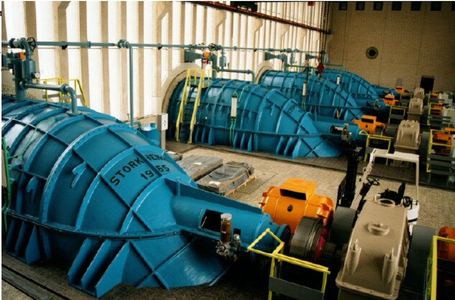
AFBEELDING 2.11 DE ELEKTRISCH HORIZONTALE SCHEPRAD- POMPEM VAN HET J. C. GEMAAL TE STAD 1966
