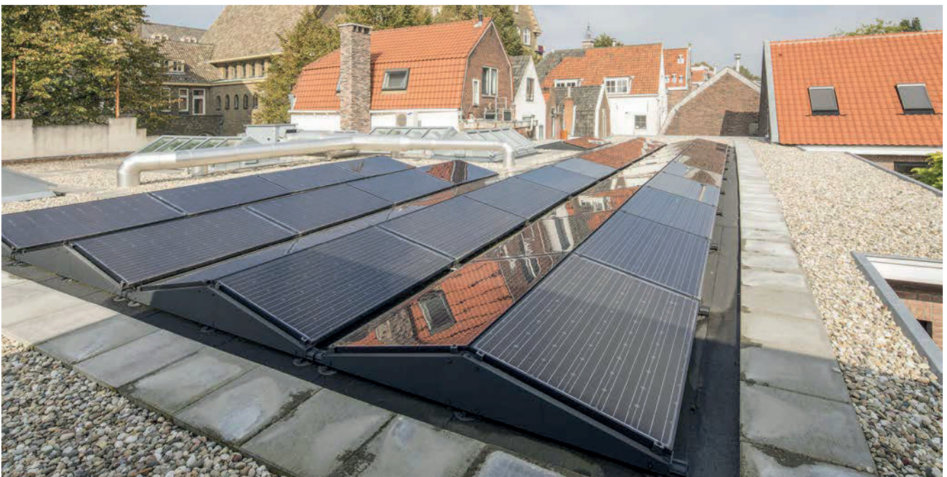
Oost-west-opstelling op een plat dak, Leiden, beschermd gezicht Leiden.
