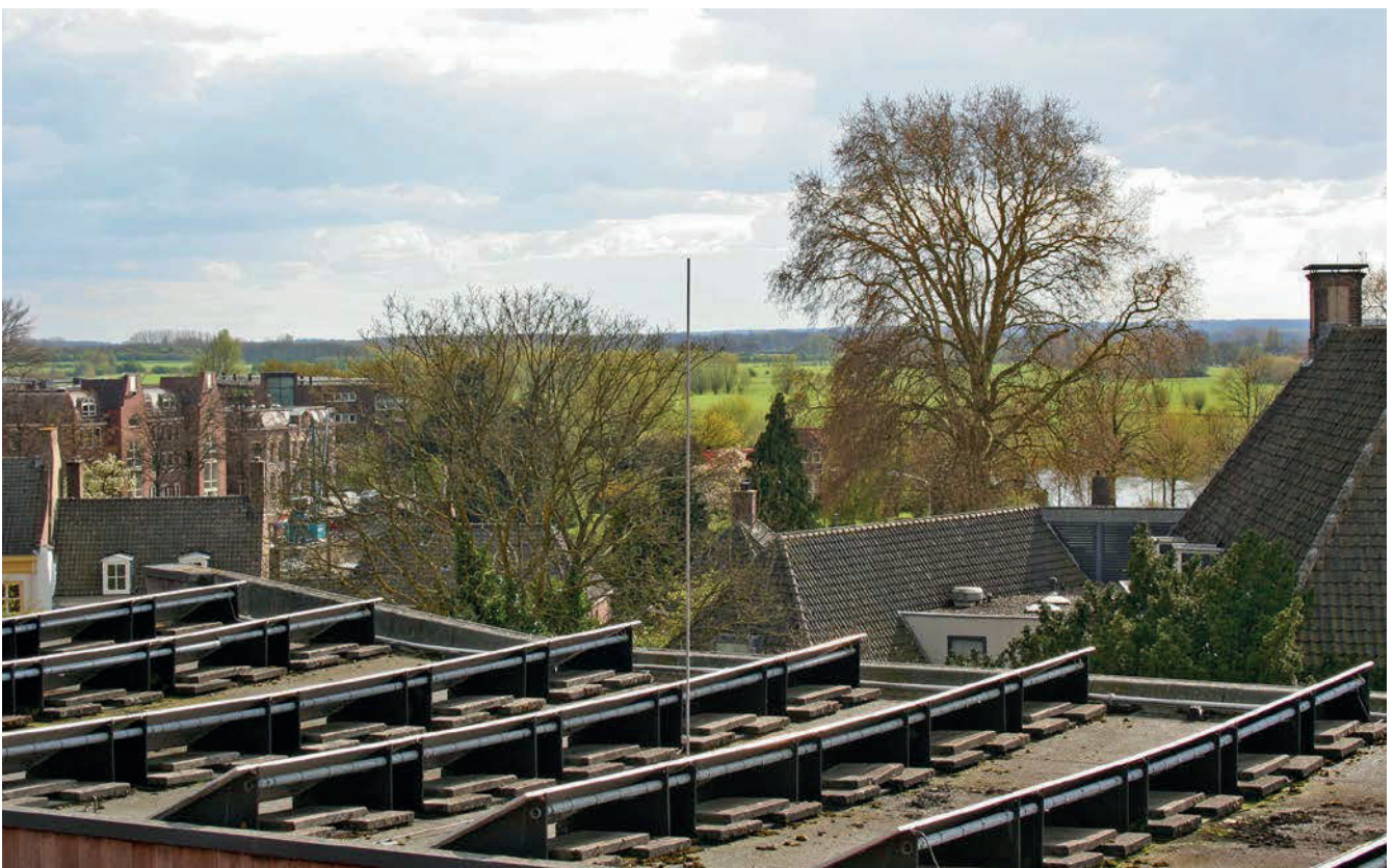
Zutphen, zonnepanelen op plat dak met bliksemafleider.
