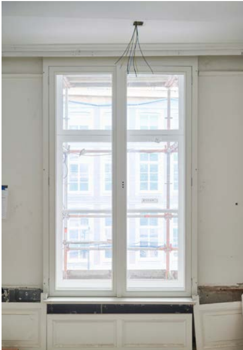
Een voorbeeld van een binnenvoorzetraam dat past binnen de monumentale waarde van het gebouw.
