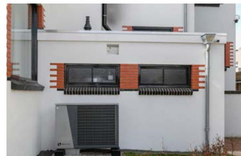
De buiten-unit van een warmtepompinstallatie
