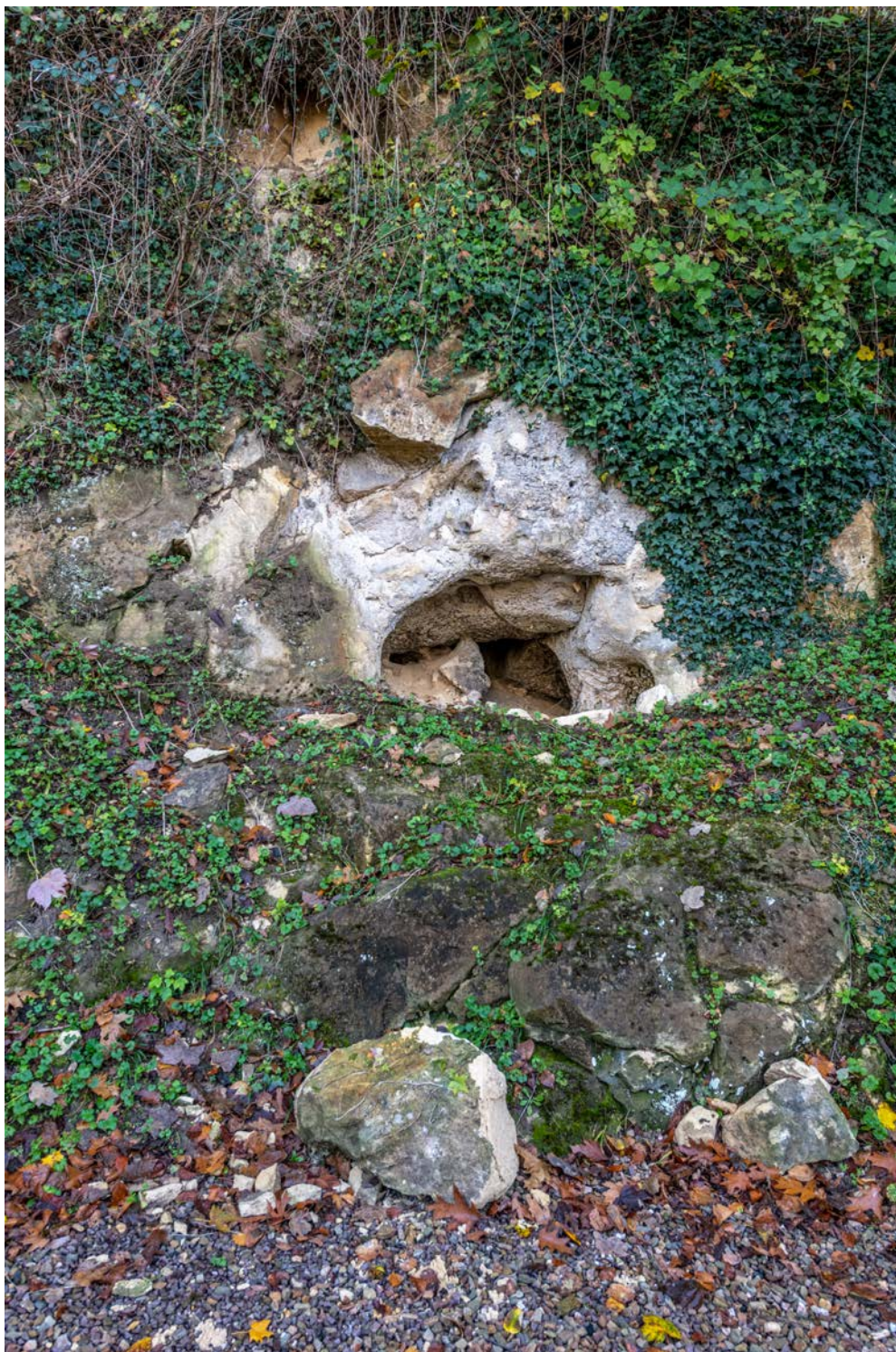
Figuur 4: Af en toe breken redelijk grote brokken mergel los uit de mergelwand. Deze erosie is niet alleen tot degradatie van het rijksmonument, maar is tevens een potentieel gevaar voor het publiek. Foto: RCE, Jos Stöver
