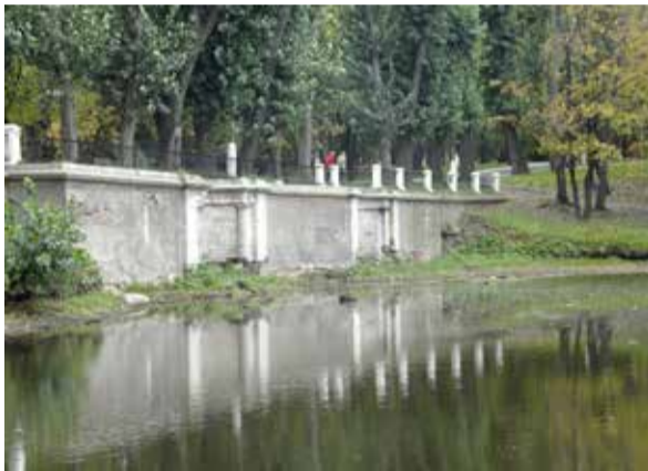
Все водные сооружения (ароты, фонтаны и каскады) сильно повреждены
