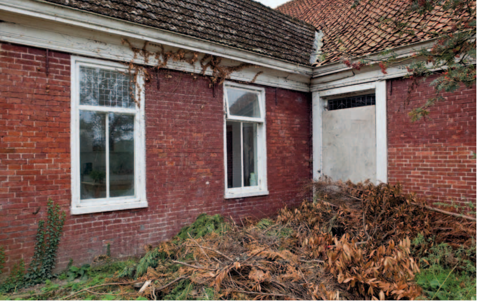
Een rijksmonumentale boerderij in Wedderveer in Groningen, met een dichtgetimmerde deur. Elke dag komt er een monumentale boerderij leeg te staan, elke week twee kerken en elke maand een klooster
