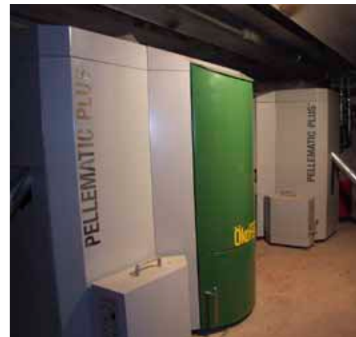
CO 2 -neutrale houtgestookte cv-ketel in de kelder van een achttiende-eeuws huis
