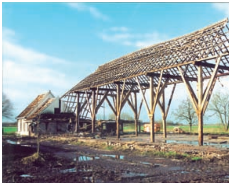
Ook buiten historische stadskernen zijn vaak interessante bouwsporen te vinden, zoals bijvoorbeeld bij deze gesloopte boerderij in de buurt van Groningen. Foto: Taco Tel, Dienst RO/EZ, Gemeente Groningen.
