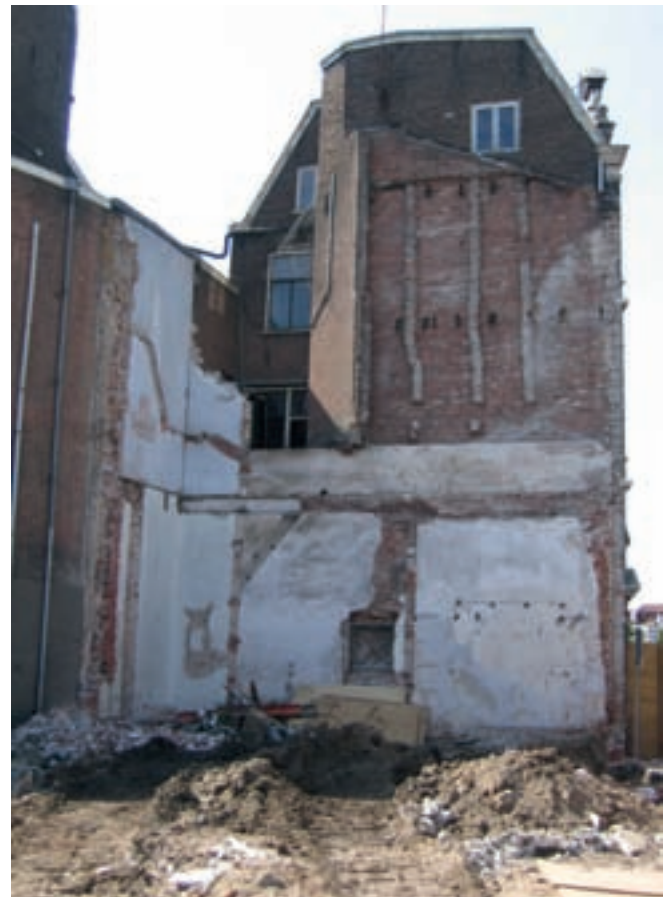
De rechterzijgevel van de voormalige Aalmarktschool met in het onderste deel muurwerk van het gasthuis, dat hier in het midden van de vijftiende eeuw werd gebouwd.
