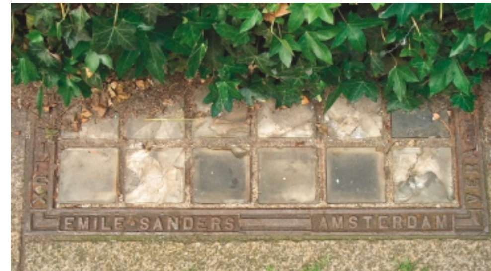
Kelderlicht van Emile Sanders met prismategels van Vera-Lux aan de Keizersgracht 496 te Amsterdam. De gebroken prisma's laten de kwetsbaarheid van deze kelderlichten zien
