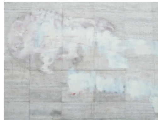
Travertin gevelplaten die visueel zijn aangetast doordat men graffiti heeft proberen te 'ontstoren' met verf (foto Michiel van Hunen)
