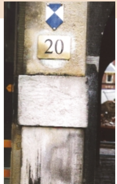
Zandstenen deuromlijsting die zwaar is beschadigd door het verwijderen van graffiti met verkeerde reinigingstechnieken (foto Michiel van Hunen)
