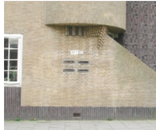
Sterk gereinigde plekken verraden de plaats waar graffiti zijn verwijderd (foto Michiel van Hunen)
