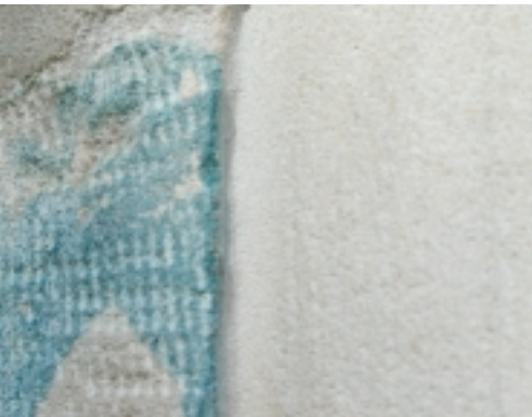
Zandstenen gevelblokken die door graffiti en het verwijderen daarvan zijn beschadigd. De verf is zo diep ingedrongen dat deze niet meer zonder schade is te verwijderen. De graffiti zijn hier verwijderd door een laag van het oppervlak af te hakken. In plaats van het verwijderen van de graffiti hadden deze ook overgeschilderd kunnen worden met een minerale verf (foto Marc Stappers)
