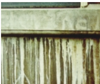
Esthetische schade, ontstaan na het verwijderen van graffiti met chemische reinigingsmiddelen, waarbij het ondergelegen gevelmateriaal niet afgeschermd is geweest (foto Michiel van Hunen)
