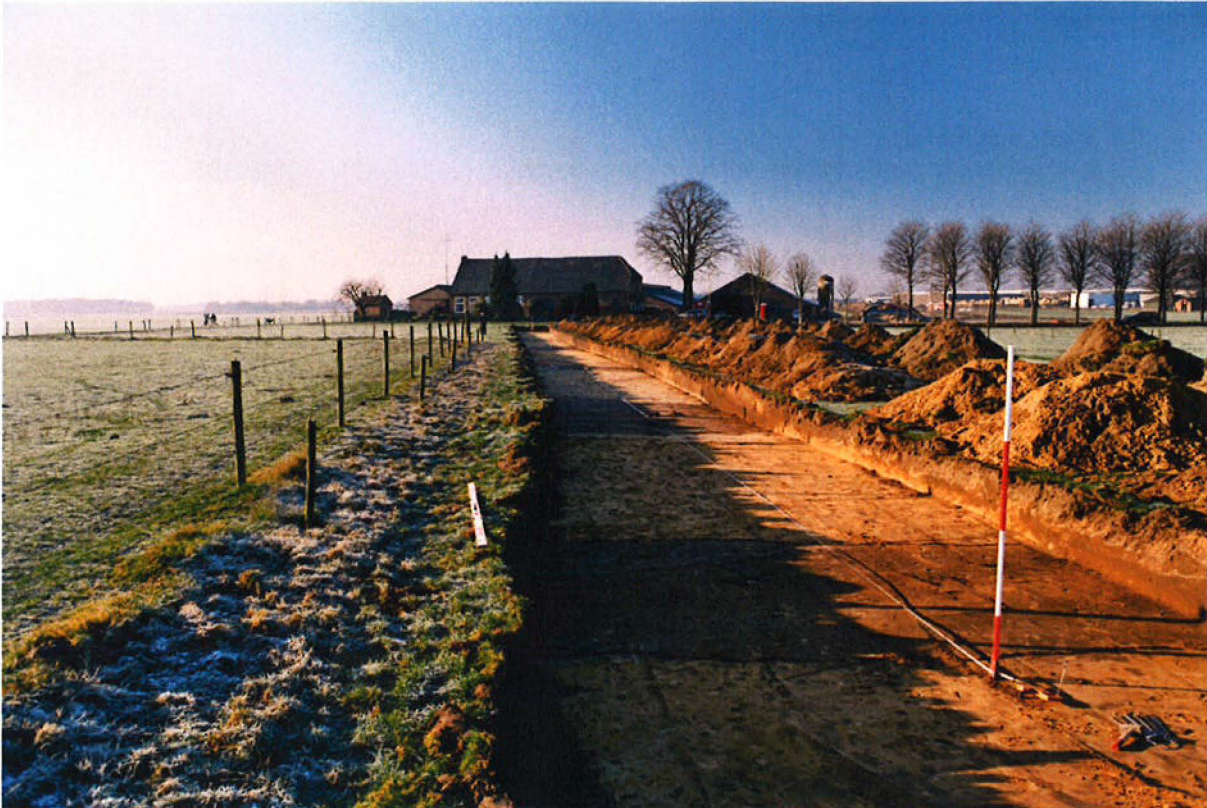
Afb. 3 Foto van de proefsleuf van oost naar west. Op de voorgrond ligt het restant van de vermoedde omgrachting, op de achtergrond de Prinsenhoef.
