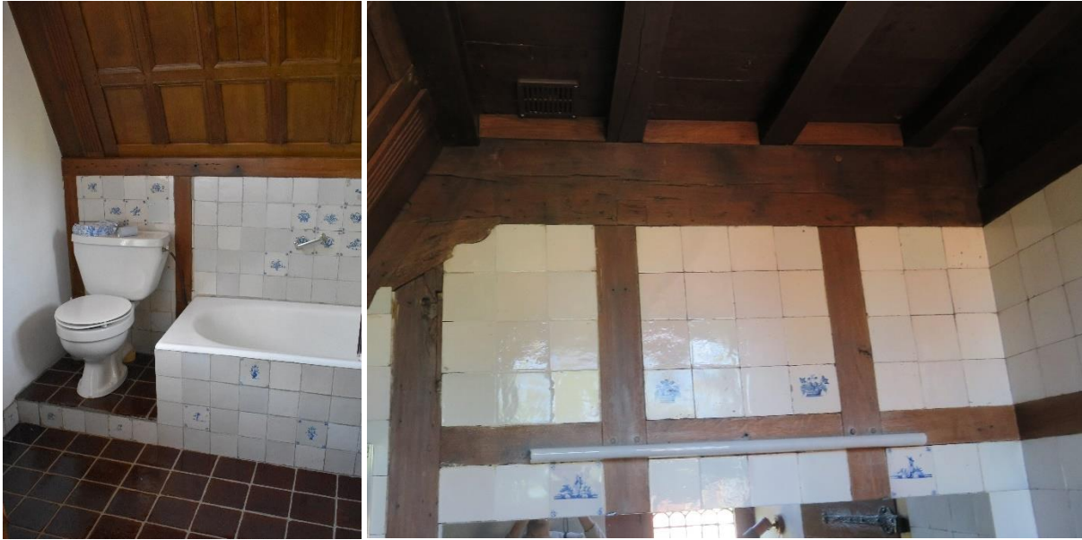
107 en 108 – WC en bad recentere periode | Vakwerk scheidingswand tussen badkamer en slaapkamer
