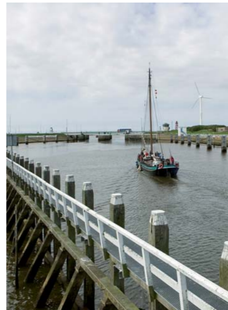
De schutsluizen van Den Oever en Kornwerderzand zorgen voor het doorlaten van schepen van en naar de Waddenzee
