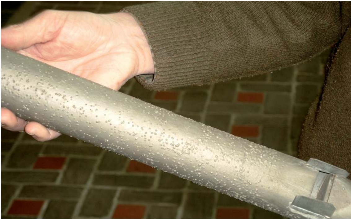
Koewacht, RK kerk, pijpwerk oxidatie
